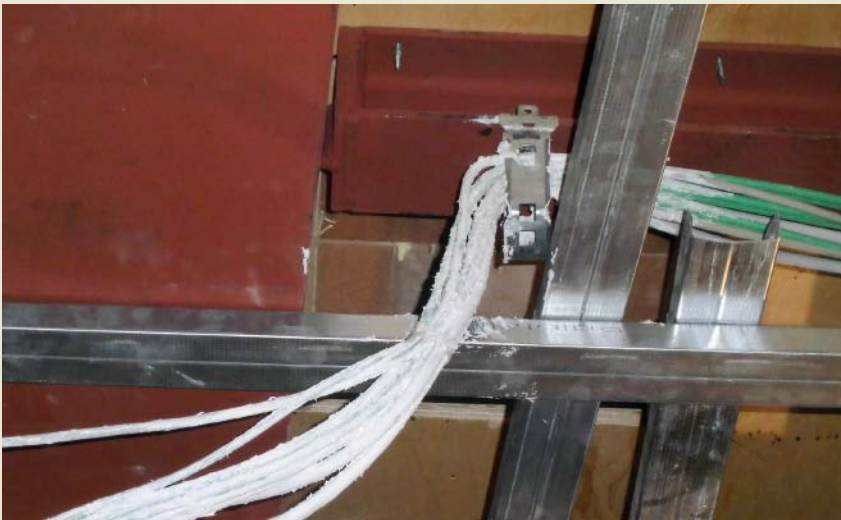
An der Rohdecke. Kabel und Leitungen führen an sechs Punkten durch die Brandschutzdecke. Gehalten werden die Leitungsbündel im Deckenhohlraum mithilfe der Abhänger.
