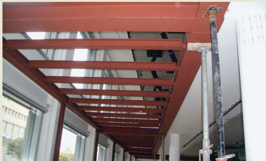
Stahlbau als Rohdecke. Zusätzliche Büroflächen fürs EG zu schaffen, bedeutete einen bisherigen Luftraum zu schließen und natürlich brandschutztechnisch einzukapseln.
